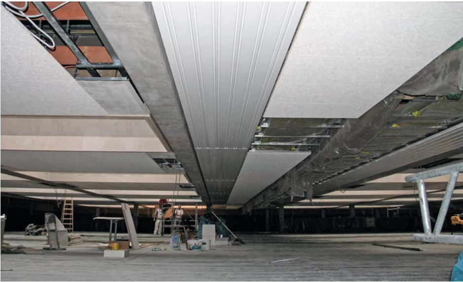
In der Sporthalle Herkenrath wurde ein Flächengerüst genutzt, um die Arbeiten an der Decke auszuführen. Die DSP mini sind flächenbündig in die Konstruktion integriert
