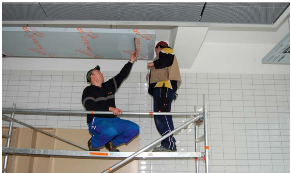
Im Anbau des Hallenbads Gießen wurde ein Rollgerüst eingesetzt, um die HKE-EL zu montieren
