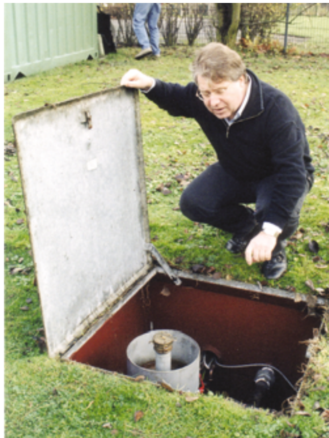
Schon die optische Kontrolle gibt wichtige Informationen über den Anlagenzustand
